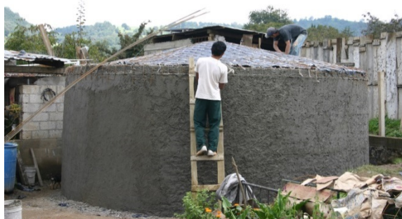
Foto 12. Aplanados exteriores y colado de tapa
