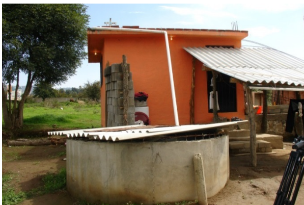
Foto 9. Cisterna de molde con protección improvisada
